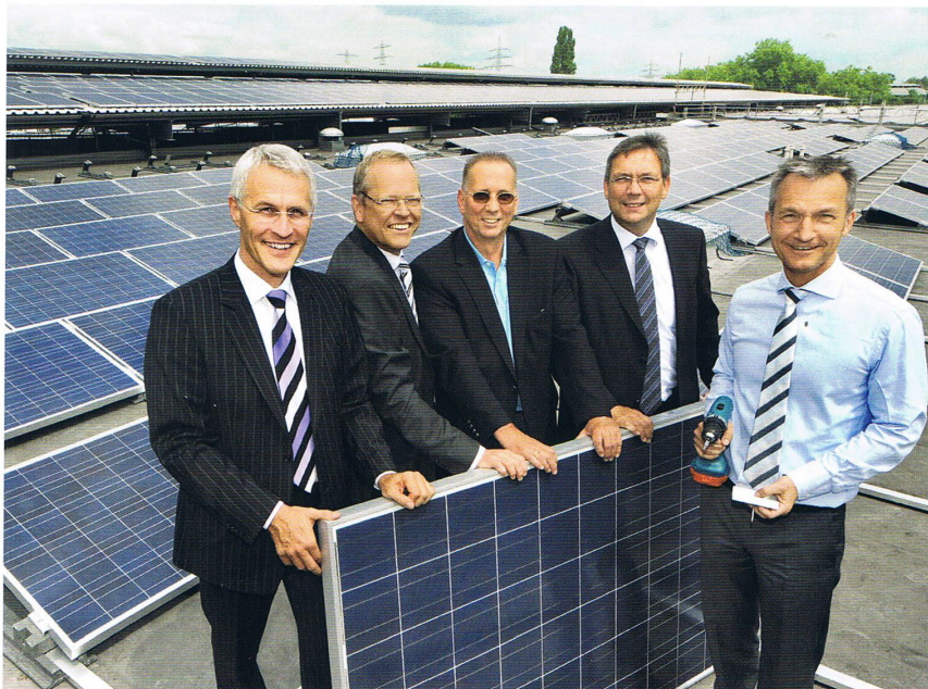
Aufs Dach gestiegen: Kurt Rommel, Geschäftsführer der ELE und der Gesellschaft für Energie und Wirtschaft (GEW), Ulrich Köllmann (ebenfalls GEW-Geschäftsführer), Dr. Klaus Haertel (Vorsitzender des GEW-Aufsichtsrates), Bernd Böddeling (Vorsitzender des ELE-Aufsichtsrates) und Gelsenkirchens Oberbürgermeister Frank Baranowski vor der neuen Photovoltaikanlage in Ückendorf (v. l. n. r.).
