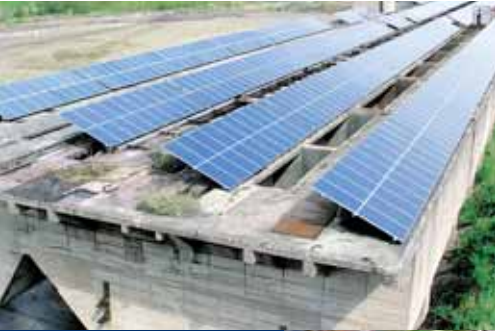
Die wohl außergewöhnlichste Solaranlage des Ruhrgebiets realisierte die abakus solar AG auf dem Erz- und Kohlebunker des ehemaligen Stahlwerks Schalcker Verein mit einer Leistung von 355 kWp.
